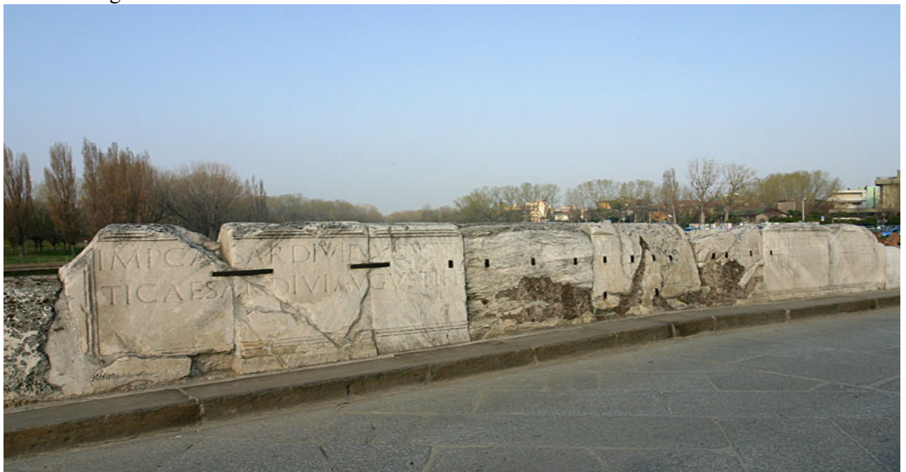
Figura 6 - Parapetto del ponte lato mare
